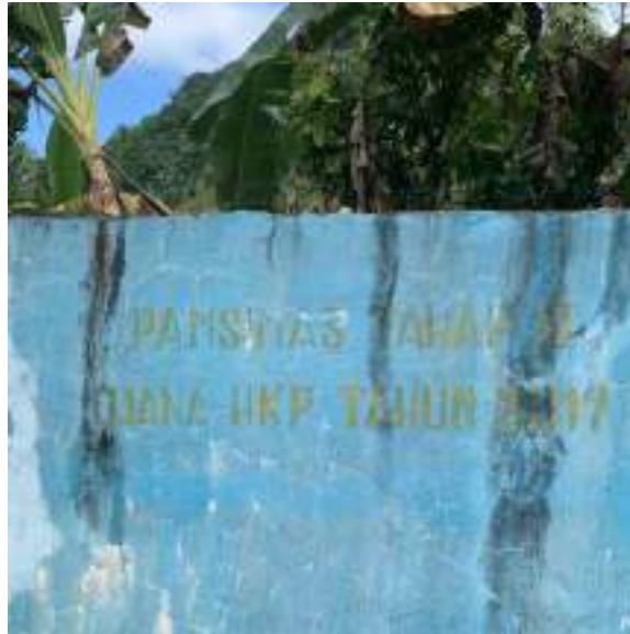
Gambar 3. 16 Salah Satu Instalasi PAMSIMAS di Kecamatan Paga
