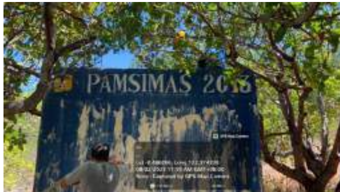
Gambar 3. 13 Salah Satu Instalasi PAMSIMAS di Pulau Koja Doi (Alok Timur)
