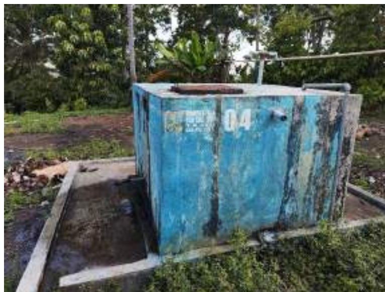
Gambar 3. 15 Salah Satu Instalasi Kran Umum PAMSIMAS di kecamatan Nita
